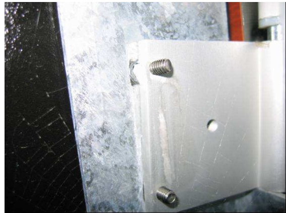
Paumelle du haut après 2 ème étape de l'essai de résistance de la porte
